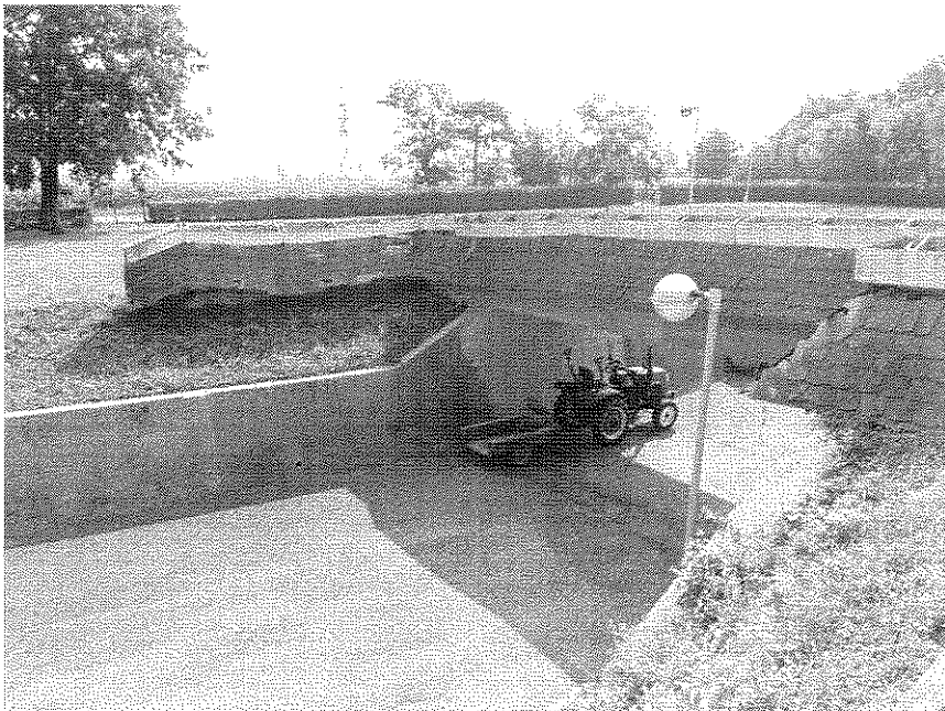
veszélyes állapotú korlát
