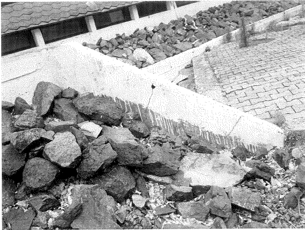
M13: Zsugorodási repedések a támfalakon (általánosan jellemző)
