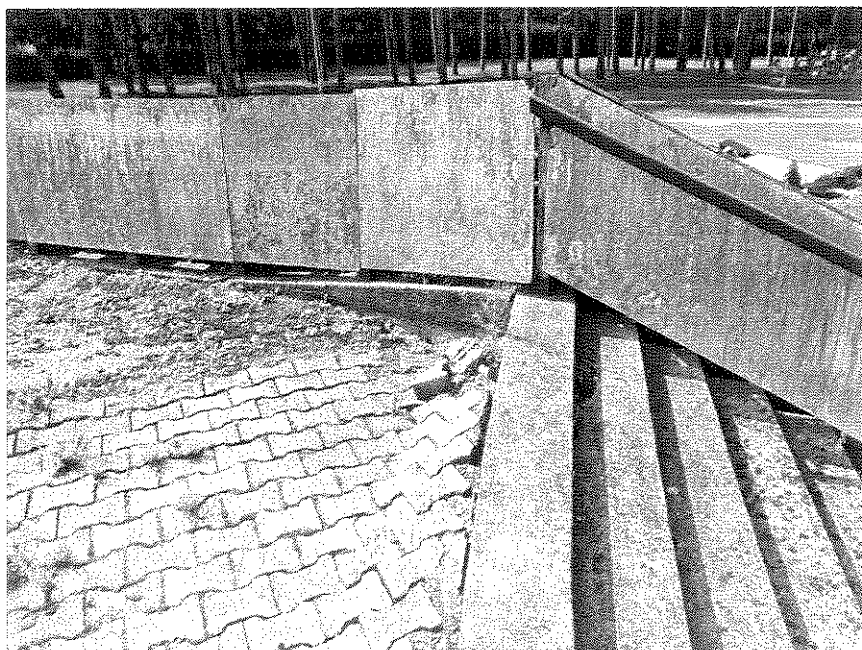
leromlott állapotú térburkolat
