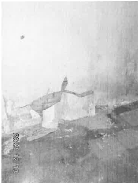
Vízszigetelési hiba és károsítása
