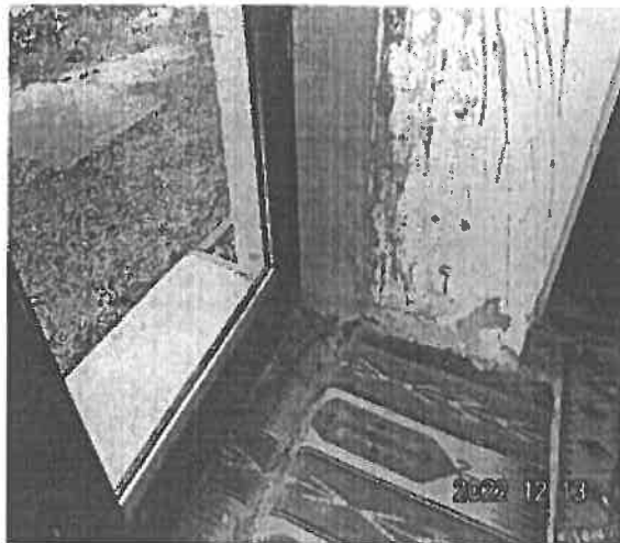
Kicserélt külső nyílászáró, rossz padozat
