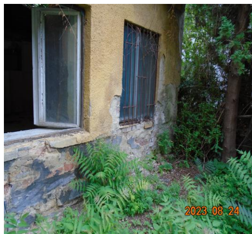
Tönkrement nyílászárók, málló vakolat
