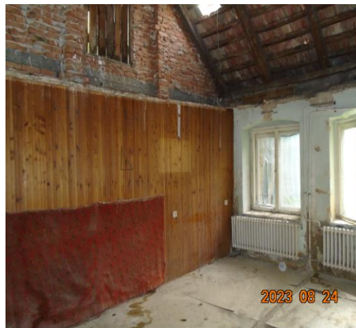
Hiányzó födém, beszakadt tetőzet
