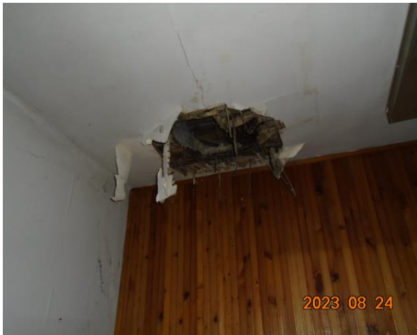
Tetőbeázás károsodása, födém hiba
