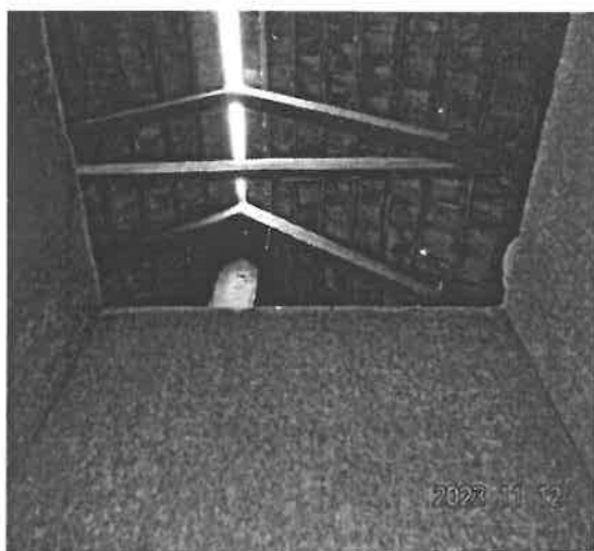
Hiányos, beázó tetőfedés
