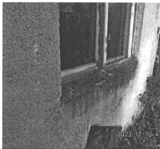
Elavult külső nyílászáró, málló vakolat
