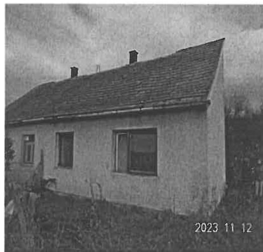
Kárpát utca 19. déli homlokzat, beázó tető
