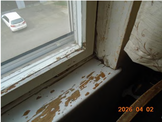
Elhasználódott fa nyílászárók
