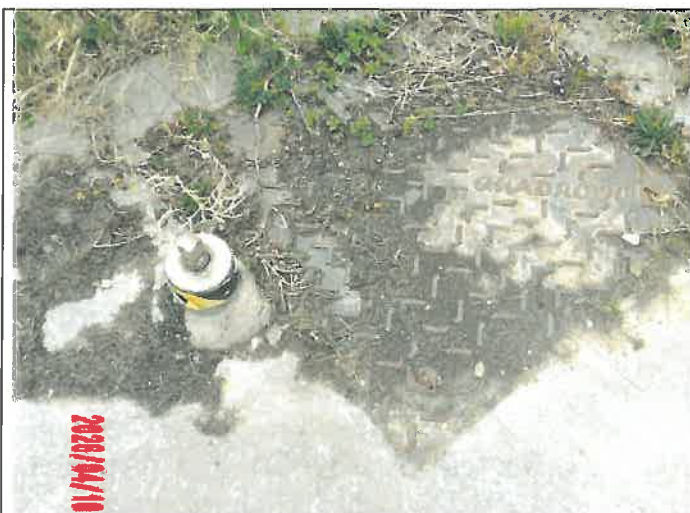
Vízcsap az É-i telekhatár környezetében
