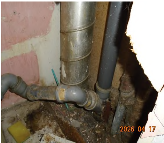
Tönkrement vezetékek, kibontott falázás
