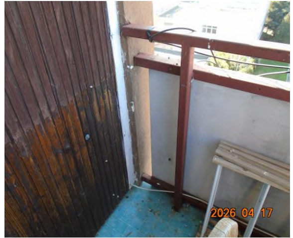
Loggia, korrodál külső elemek
