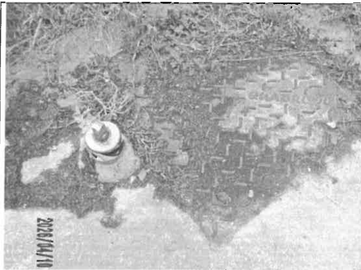
Vízcsap az É-i telekhatár környezetében
