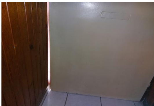
Megvetemedett bejárati ajtó
