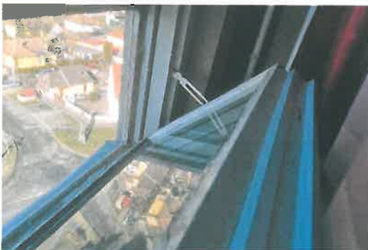
Felújításra szoruló ablak
