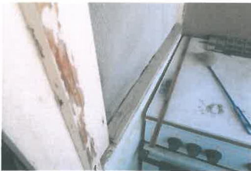
Felújításra szoruló ablak
