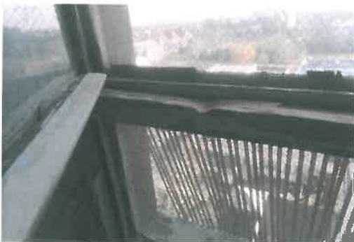
Felújításra szoruló ablak
