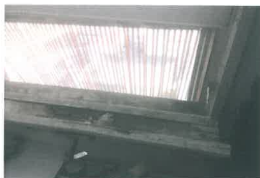
Felújításra szoruló ablak
