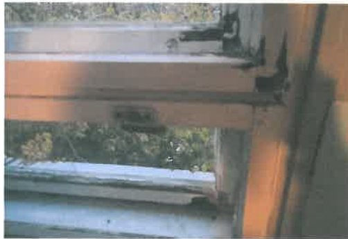
Felújításra, cserére szoruló ablak
