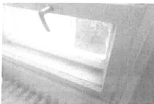
Cserére, felújításra szoruló ablak
