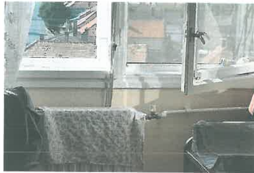
Felújításra szoruló ablak
