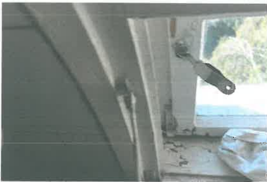
Felújításra szoruló ablak
