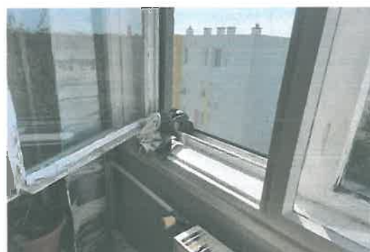
Felújításra szoruló ablak
