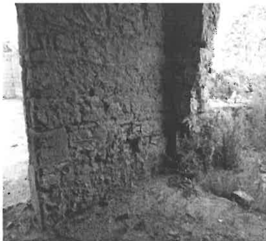
Hiányzó vízszigetelés és aljzat betonozás
