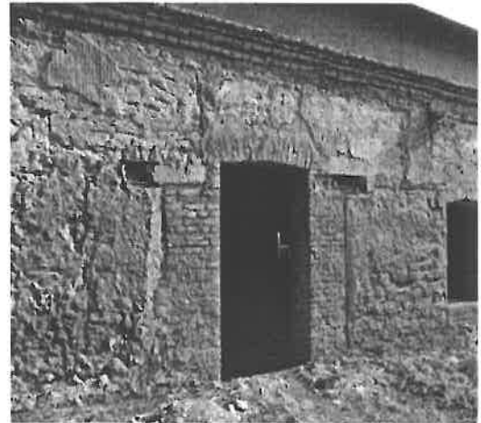
Vegyes falazat, hiányos nyílászárók
