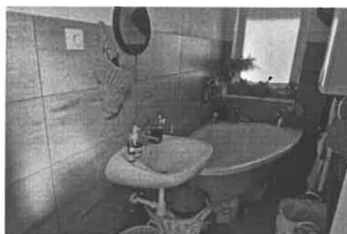
Fürdő-wc, kádburkolat hiányzik
